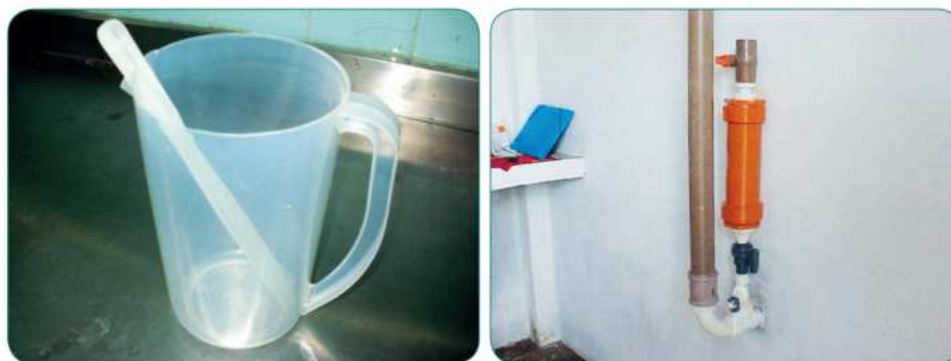
Figura 13 – Recipiente de preparo de solução e clorador instalado.
